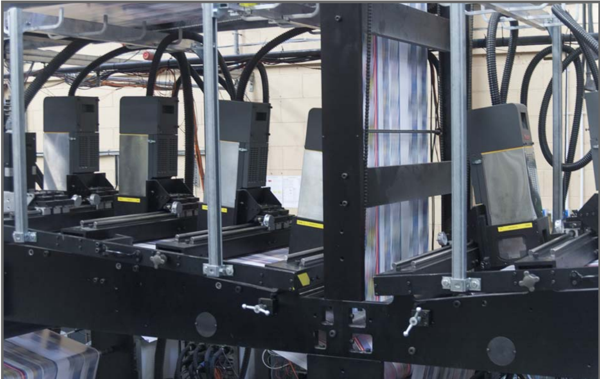
Installation von Kodak Prosper S-Köpfen in einem Lettershop: Ein speziell für die Lettershop Gruppe in Leads konstruierter Druckturm. Jeder Kopf ist auf einer Schiene montiert, so daß er beliebig über die Breite positioniert werden kann. Bild: Nesson Cleary
